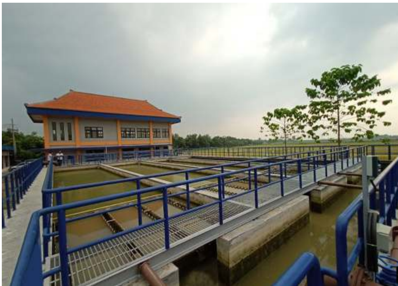
INSTALASI PENGOLAHAN AIR SPAM REGIONAL KEBOREJO
